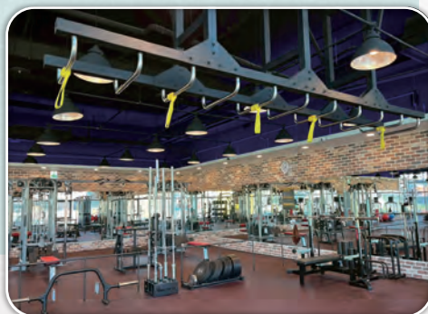
高效能LED照明設備
